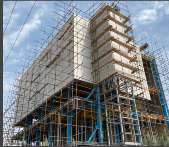
پروژه سوله و ساختمان اداری درمان یاب دارو واقع در شهرک صنعتی بهارستان کمالشهر متراژ ۴۰۰ متر
